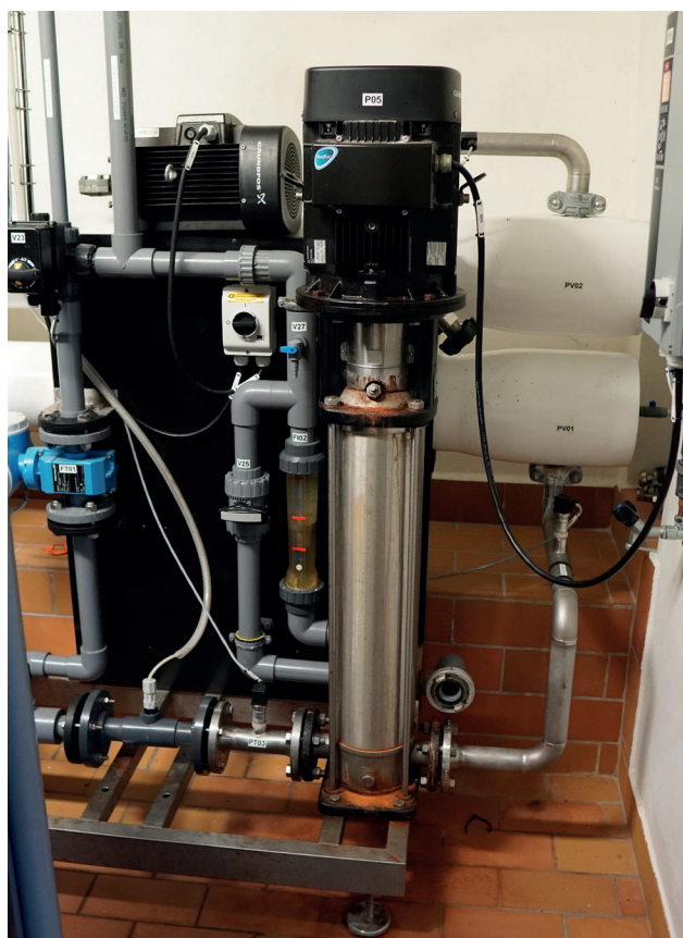
Udsnit af Christiansøs omvendte osmoseanlæg. Bag trykpumpen skimtes to vandrette hvide cylindere, der indeholder de omvendte osmosemembraner som saltvandet under højt tryk presses igennem.
