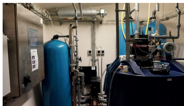
Christiansøs omvendte osmoseanlæg set fra indgangen til anlægget. Mod bagvæggen skimtes to blå sedimentfiltre. Den blå tank til venstre indeholder akdolitpiller.
