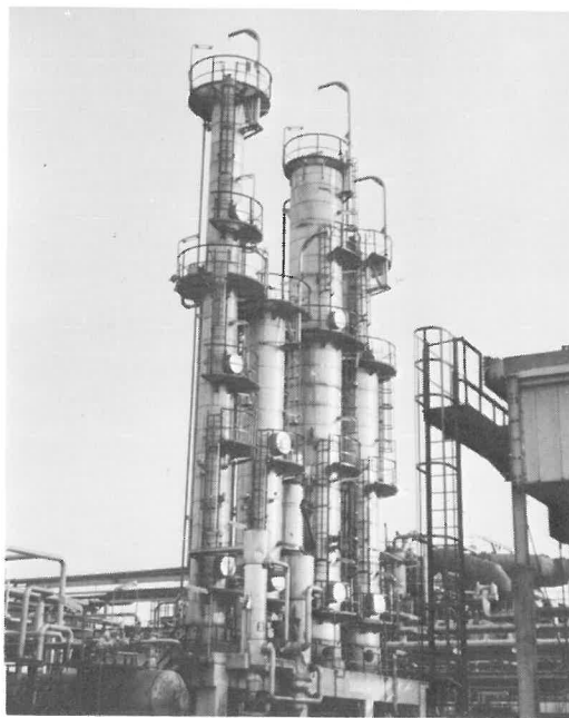
Fig. D. Destillationskolonner til reformering.
